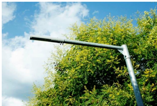
7. ábra: Új, LED-es fényforrás Salgótarjánban. Kép forrása: 3100.hu
